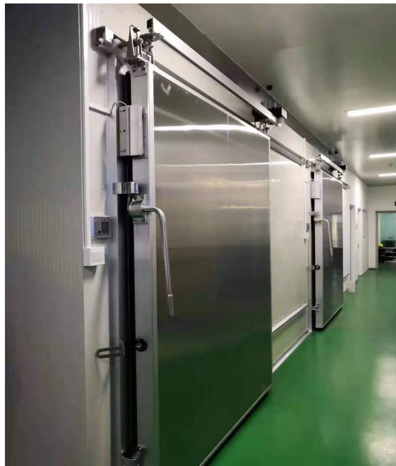
韩国冷库项目 Korean cold storage project
